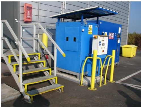
Fot. Kompresor CNG marki AquaCentrum Praha
