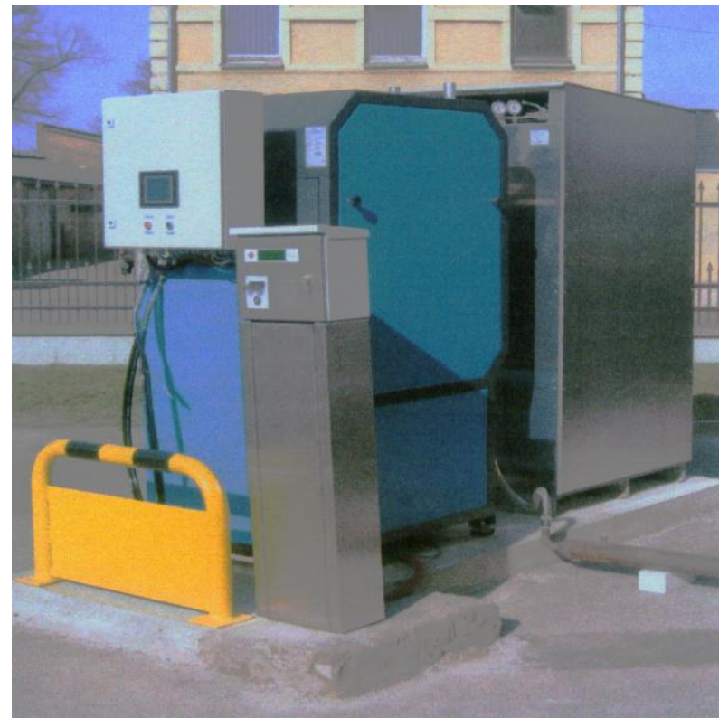
Fot. 4 Widok sprężarki BLUE
